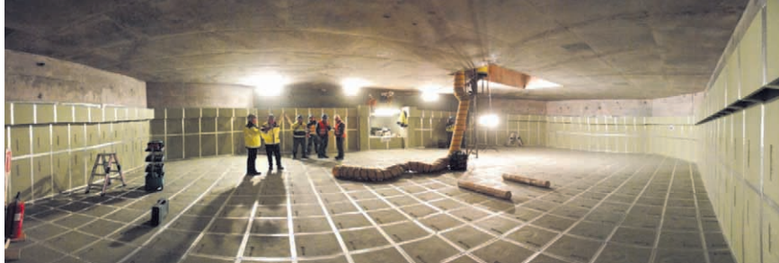
Sur cette photo, la mise en place des briques en fonte dans la chambre de récupération du corium est achevée. Elles seront ensuite recouvertes de béton "sacrificiel".
